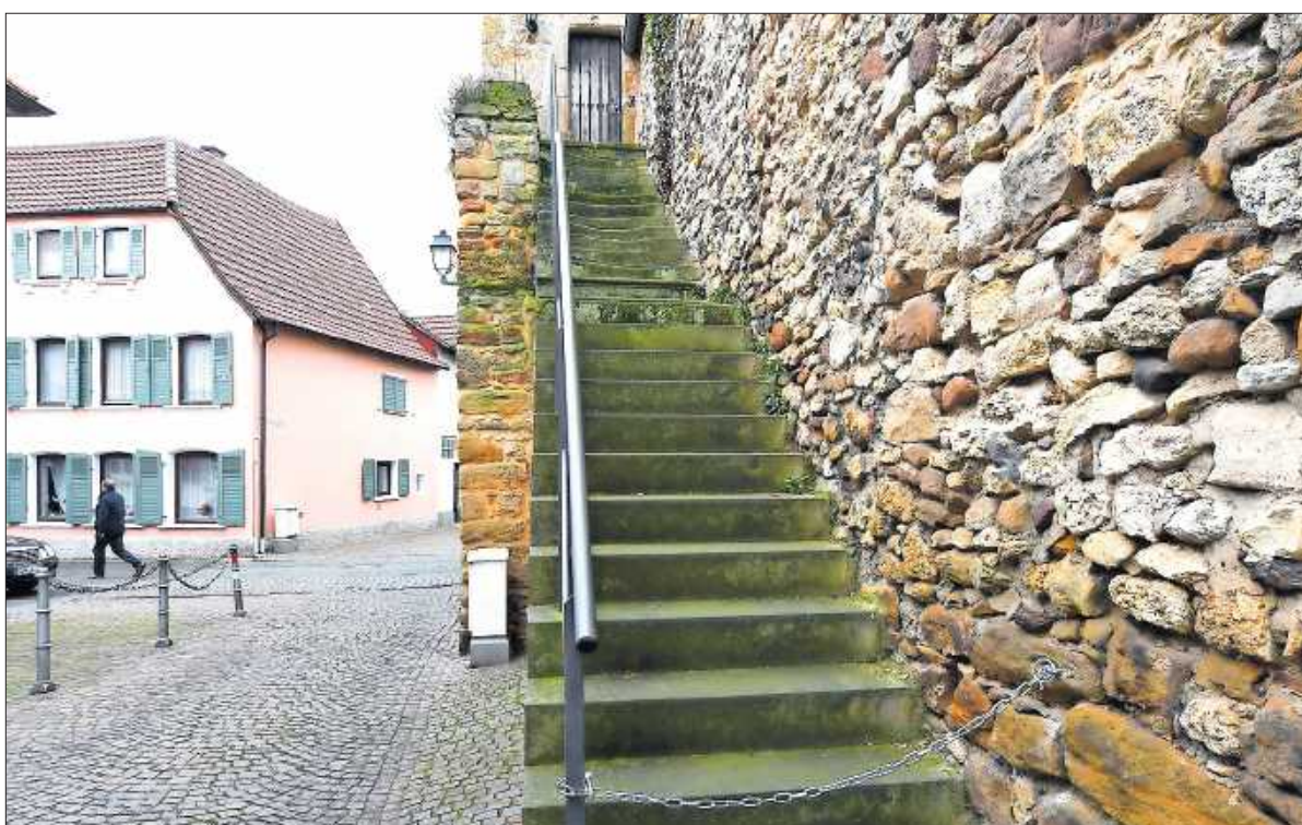
Derzeit gesperrt: Der Treppenaufgang zum Haintorturm muss saniert werden.
